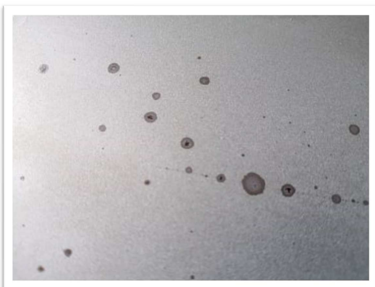
Částečně očištěné stínění, některé tečky již byly odstraněny octem, jiné z půlky. Je to o troše drhnutí.
